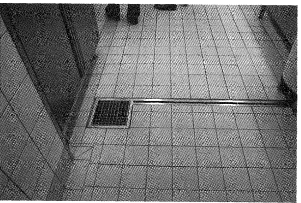
写真6 床排水事例 (排水枡とステンレスピット) / ドイツ
