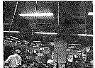
天井換気設備
