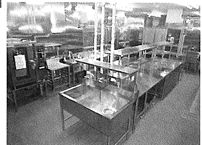
同スーパーマーケットの調理室
